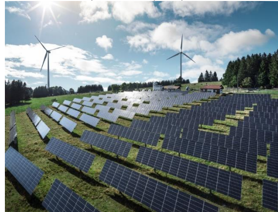
Panneaux solaires de la centrale solaire à mont soleil
